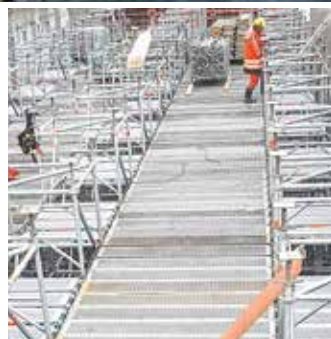
Arbetsplattformar utan snubbel- och halkrisk.
